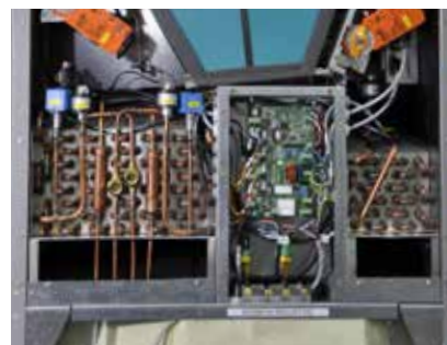
Abbildung.: Wärmetauscher und Kondensatwannen
